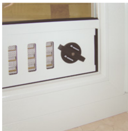
Zuluft über Dauerlüfter Einbau im Sockelbereich
